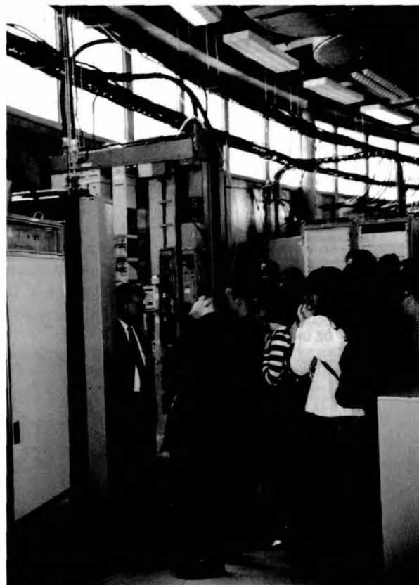
Equipos de los radioenlaces ubicados en la planta 12
