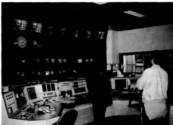
Sala de control. Se pueden observar los equipos de control y monitorización.
